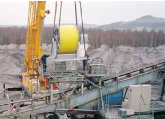
Les experts de Conductix-Wampfler aident les clients, de la planification à l'installation sur site en passant par le pré-montage, partout dans le monde.
