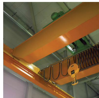
Alimentation d'un palan sur un pont roulant
