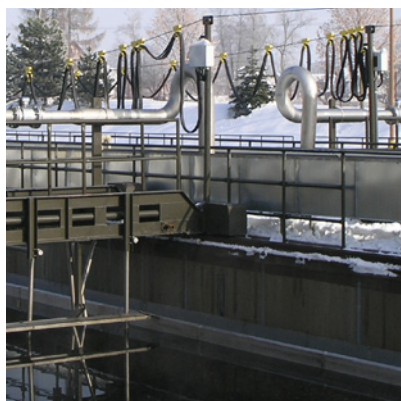
Alimentation d'un pont racler dans une station de traitement d'eaux usées
